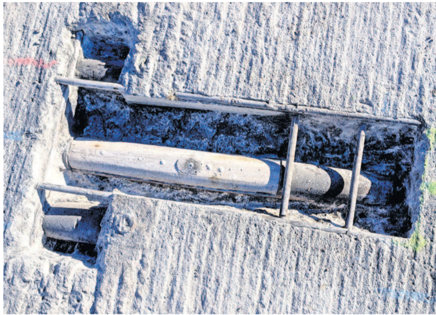
Hier ist eines der Spannglieder im abgefrästen Bereich zu sehen. (Foto: Stadtverwaltung Radeberg)
